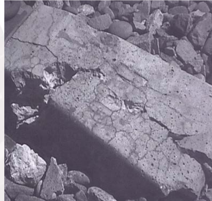
Сетка трещин на поверхности конструкции железобетонной шпалы в результате взаимодействия щелочей цемента и реакционноспособного щебня
