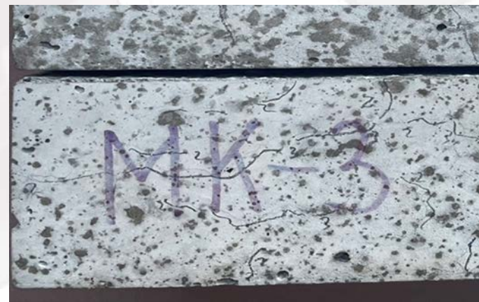
Сетка трещин на бетонном образце, изготовленном на реакционноспособном песке и не реакционноспособном щебне
