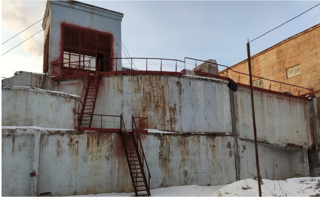
Повреждение арматуры и бетона в конструкциях здания калийного производства в результате воздействия отрицательных температур и хлористого аэрозоля
