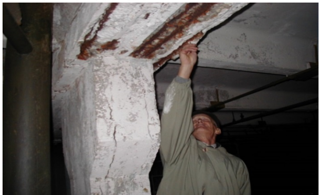
Повреждение бетона и арматуры в конструкциях таксомоторного парка в результате воздействия хлоридов (противогололедных реагентов)
