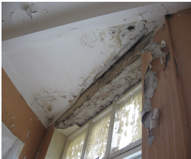
Повреждение бетона в результате биологической коррозии (плесневых грибов)
