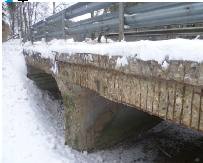
Повреждение бетона в конструкции автомобильного моста в результате воздействия отрицательных температур и противогололедных реагентов
