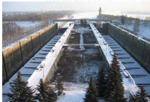
Повреждение стен шлюза Рыбинского гидроузла в результате воздействия отрицательных температур на водонасыщенный бетон
