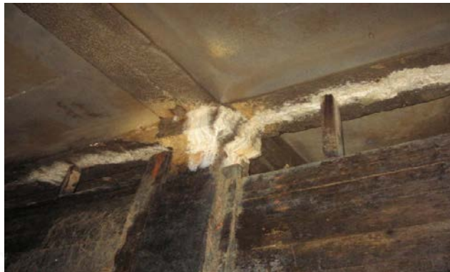
Выщелачивание бетона в перекрытии подземного резервуара водопроводной станции
